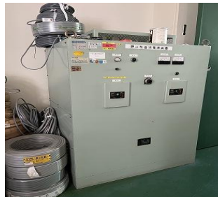
直流電源装置
